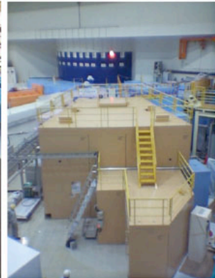
完成したインターロックシステム (赤色信号はシャッターopenのサイン)
